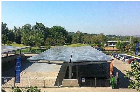
Les panneaux couvrent 2600 m 2 sur le parking du siège social d'Eskom.
